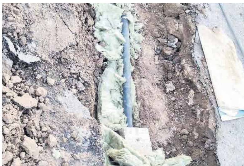
Tubería de agua rota en las Casas del Pino de Canteras tras una avería reciente.
